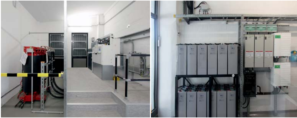
Bild 3 und 4: Ein Blick in den Maschinenraum: Das Micro Smart Grid ist über einen 630 kVA Transformator und eine Mittelspannungsschaltanlage an das übergelagerte Mittelspannungsnetz angeschlossen. Rechts das Speichersystem des solaren Grundlastkraftwerks. © inno2grid
